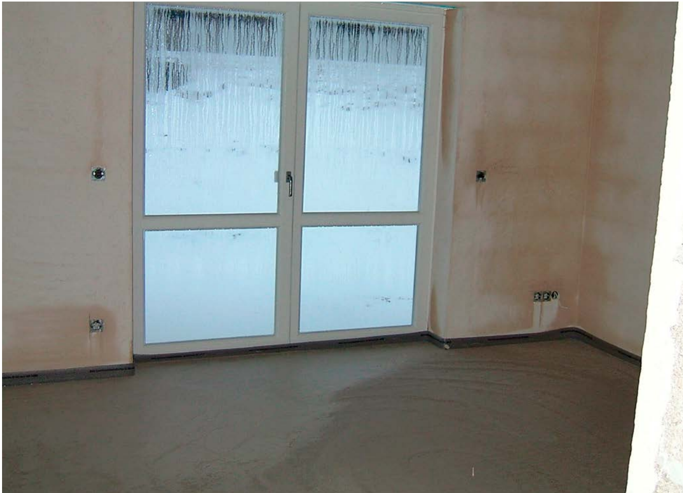
Abbildung 20: Schimmelschaden durch Neubaufeuchte (Quelle: S. Betz, Sachverständigenbüro für Gebäude- und Innenraumanalytik, Hellertshausen)
