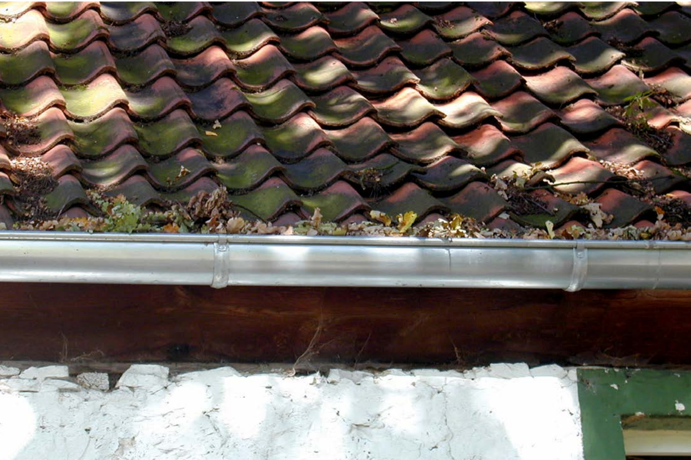
Abbildung 21: Verschmutzte Dachrinne (Bildquelle W. Lorenz, Institut für Innenraumdiagnostik, Düsseldorf)
