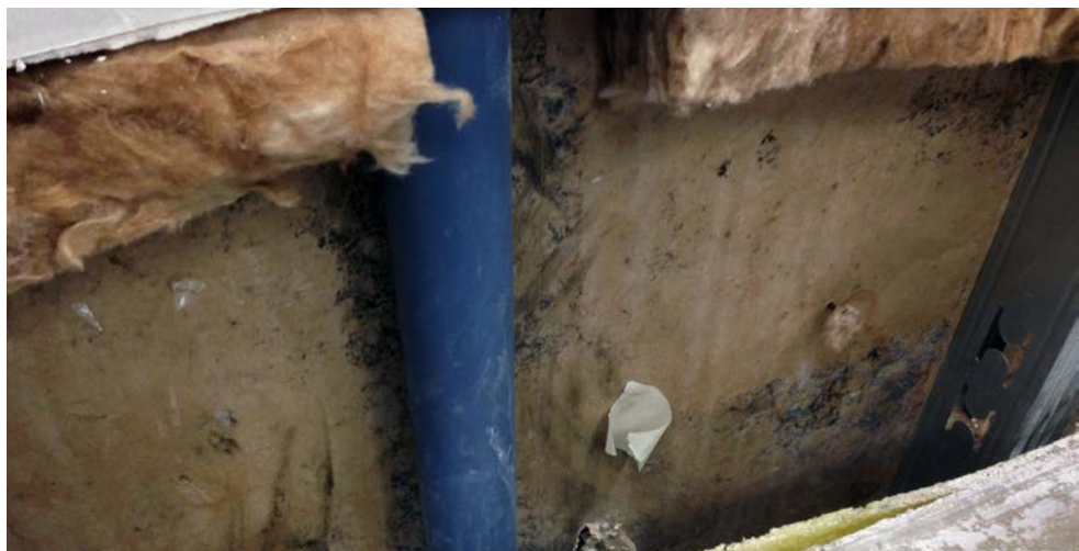
Abbildung 3: Verdeckter Schimmelschaden, Innenbereich Leichtbauwand (Quelle: P. Tappler, IBO Innenraumanalytik OG)
