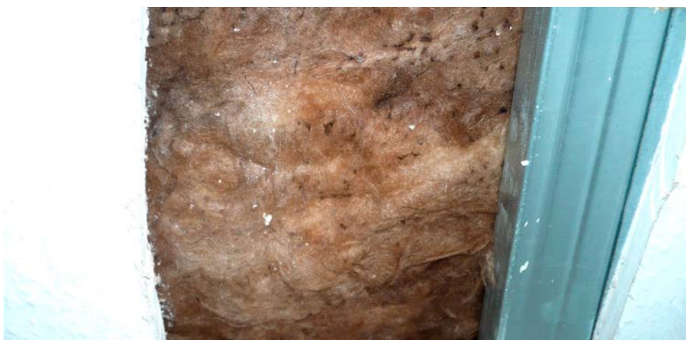
Abb. 19: Schadensbild Innendämmung (Quelle: S. Betz, Sachverständigenbüro für Gebäude- und Innenraumanalytik, Hellertshausen)
